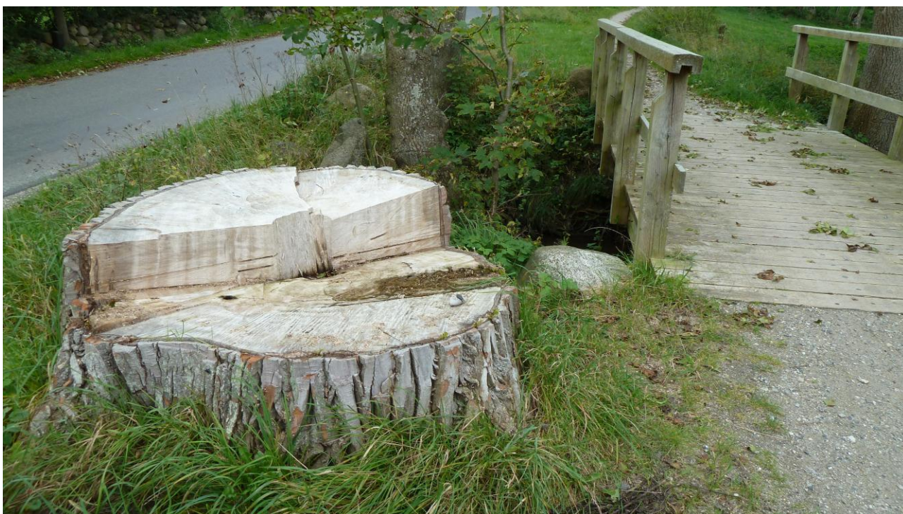
2. For nogle år siden anlagde Naturstyrelsen og Rønne Kommune en gangsti over Knubbro Bæk, og denne sti førtes over en bro parallel med stenkisten, der altså går under vejen til venstre i billedet. Træstubben markerer, at der indtil for et par år siden stod en kæmpe poppel lige ved stenkisten. Billedet er taget fra vest (møllesiden) mod øst.
